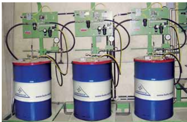
Zentrale Schmierstoffversorgung mit CEPLATTYN KG 10 HMF. Central lubricant supply with CEPLATTYN KG 10 HMF.
